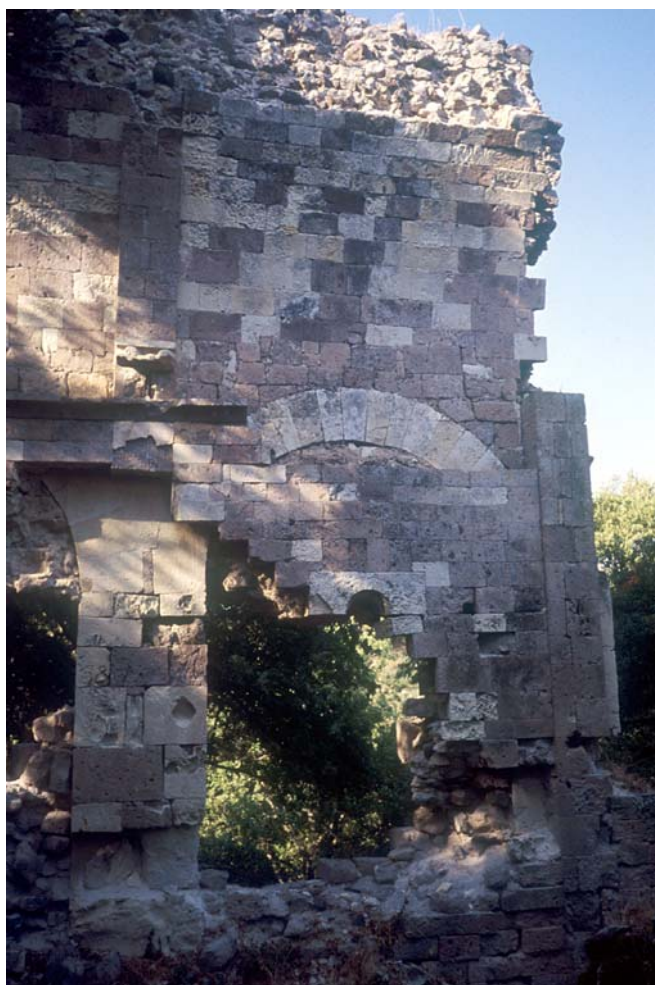
Monteleone Roccadoria, Santa Maria di Curos: parete interna del prospetto nord (agosto 1997).
