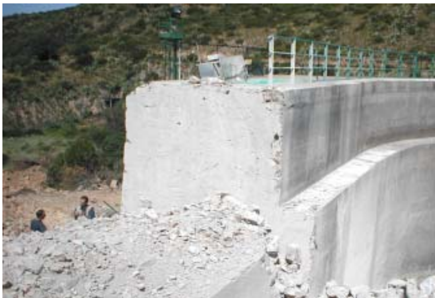
LA PARTE SUPERIORE DEL CORPO DIGA SUBITO DOPO LA DEMOLIZIONE. LA SEZIONE IN VISTA RAPPRESENTA LA PRIMA DELLE DUE FASI DI TAGLIO.
