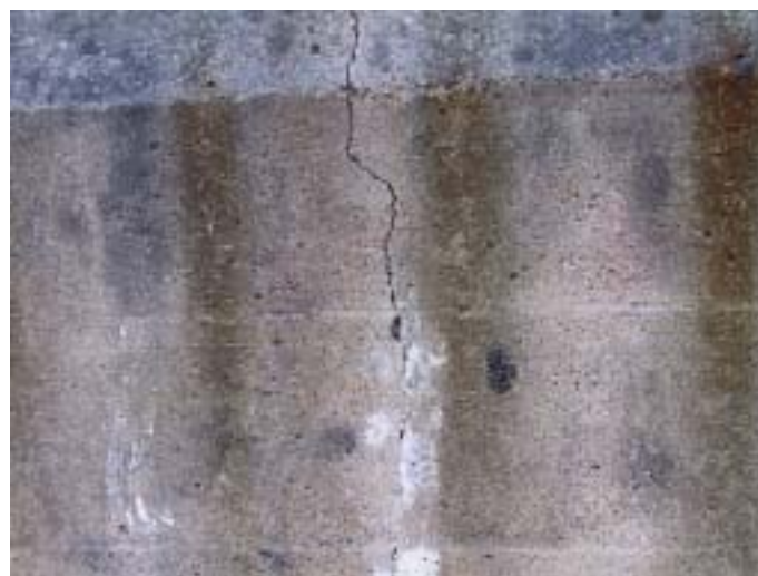
QUI SOTTO: FESSURE DA RITIRO IGROMETRICO SU UN MURO DI CALCESTRUZZO.
