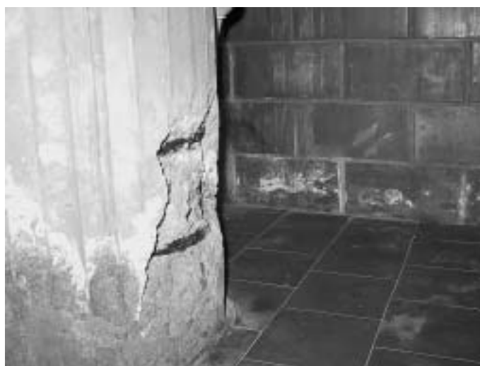
CARBONATAZIONE CON ESPULSIONE DEL COPRIFERRO PER CORROSIONE DELLE BARRE DI ARMATURA ALLA BASE DI UN PILASTRO IN CEMENTO ARMATO IN INTERNO.
