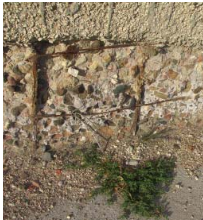
EFFETTO COMBINATO DELLA CRISTALLIZZAZIONE SALINA E DELLA CORROSIONE DELL'ARMATURA SU UN MANUFATTO DI CALCESTRUZZO.
