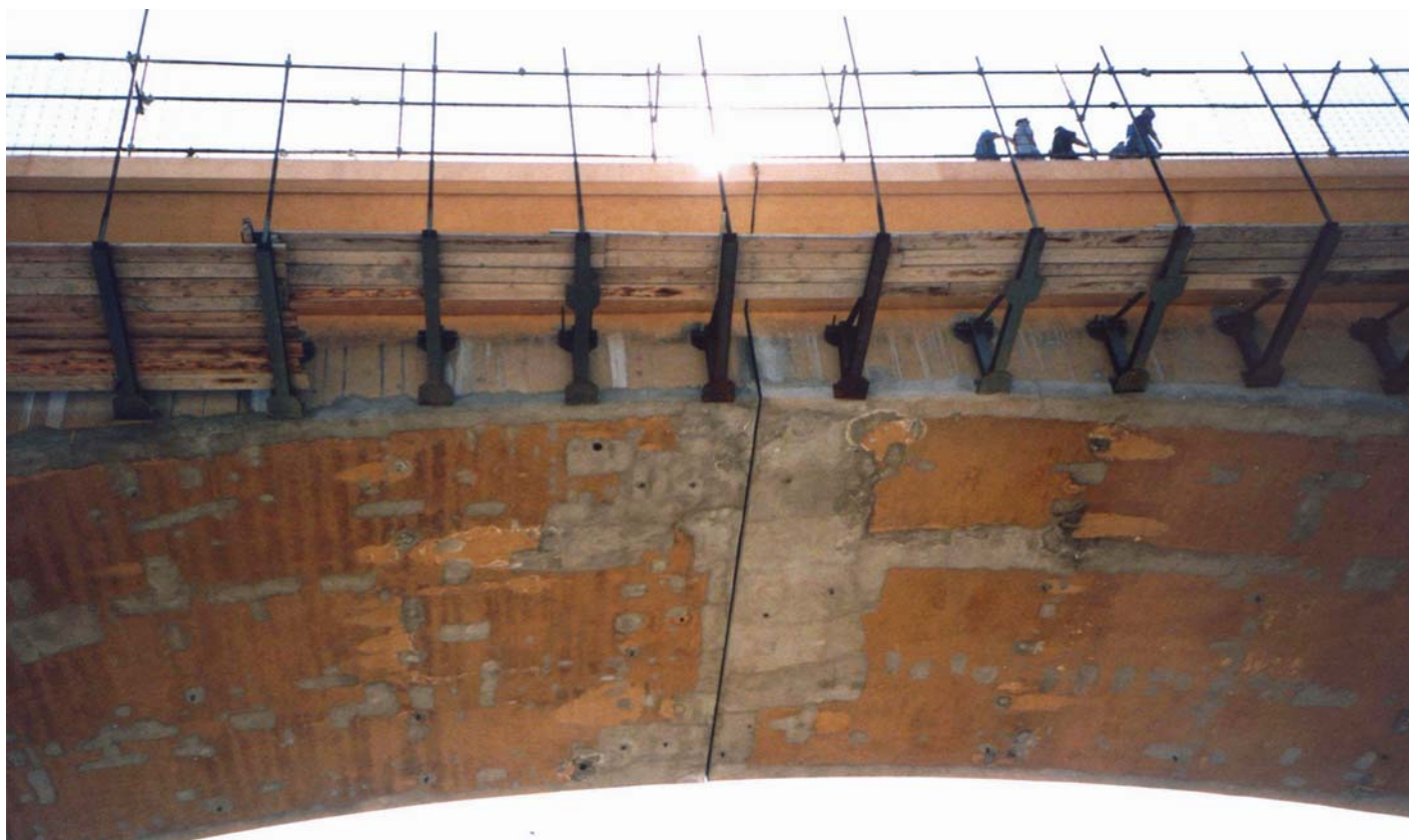
IL GIUNTO DI COLLEGAMENTO TRA I DUE PONTI DOPO L'INTERVENTO DI RISANAMENTO.
